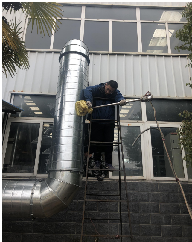
有组织排气筒进口
